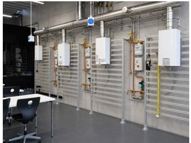
Wandarbeitsplätze mit Energiesäulen
